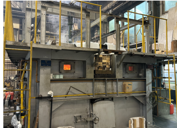
耐火炉の外観
