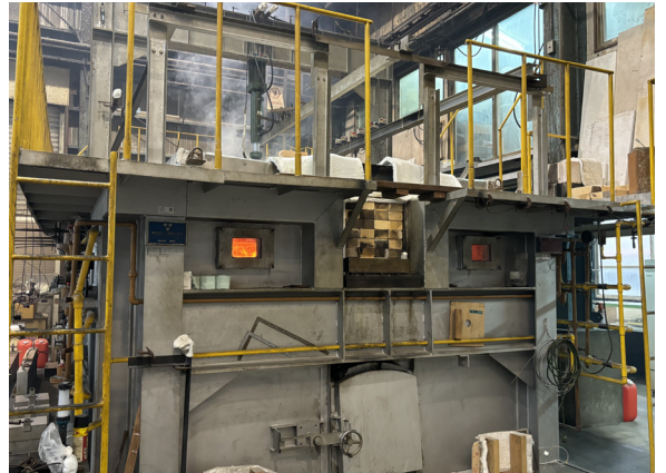
耐火炉の外観
